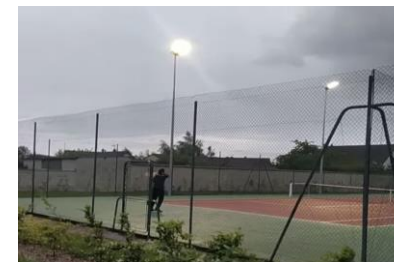
Eclairage courts extérieurs 1 et 2
